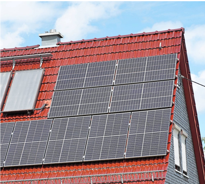
Solarthermie-Anlagen für die Warmwasserversorgung machen einen auch unabhängiger von künftigen Energiekrisen. imago/Elke Münzel
