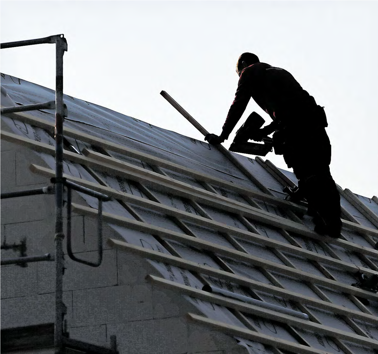
Nicht jeder, der auf ein Dach steigt, ist ein gelernter Handwerker. Betrüger sind darauf aus, vor allem Senioren um ihr Geld zu bringen, indem sie vermeintliche Schäden feststellen.
