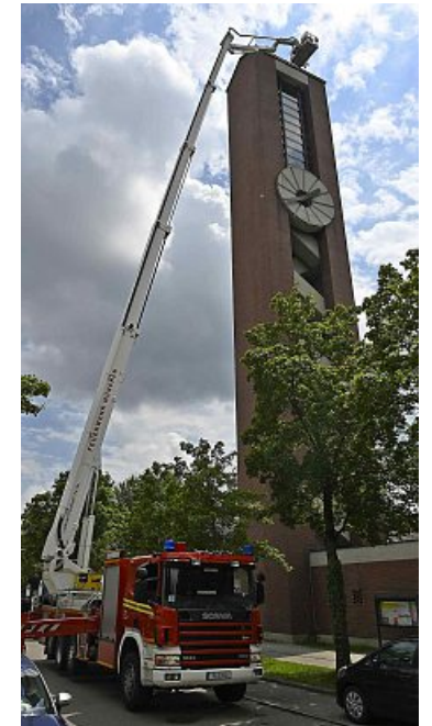
Die Feuerwehr sicherte das Dach der Kirche St. Helena in Obergiesing.
