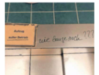
Neben das Schild „Aufzug außer Betrieb“ hat ein Mieter „Wie lange noch???“ geschrieben.
