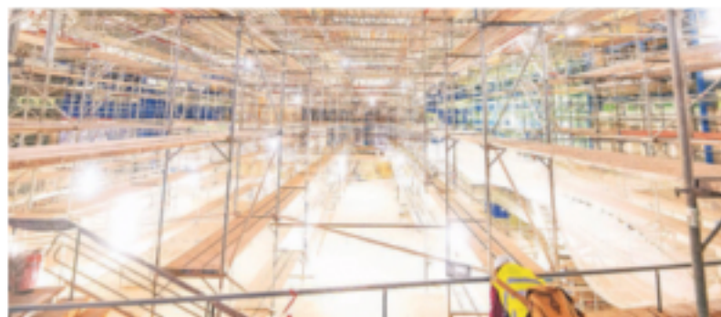
Im großen Saal stehen noch immer Baugerüste. Die statischen Probleme mit der Saaldecke sind bisher ungelöst. FOTO: BENJAMIN WESTHOFF
